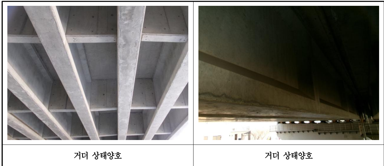
【사진 1.3.5】 거더 손상현황
