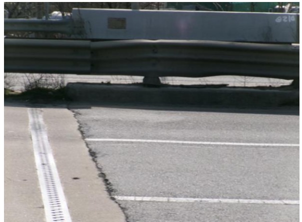
S1 중앙분리대 가드레일 지주파손, 변형
