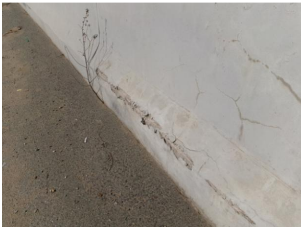
S2 방호벽 파손(0.12×1.5m)
